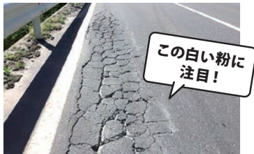
亀甲状クラック発生状況
